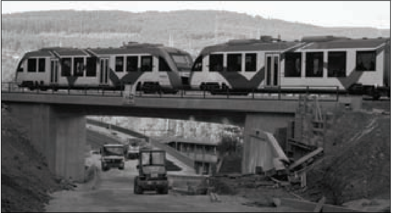
Großbaustelle Niedernhausen (Taunus) kurz vor der Fertigstellung: Unterführung unter der Main-Lahn-Bahn anstelle eines Bahnübergangs und Verbreiterung der einspurigen Unterführung unter der Ländchesbahn auf der L 3028, Zubringer von der Autobahn – 15 Jahre geplant – Bauzeit zwei Jahre.
